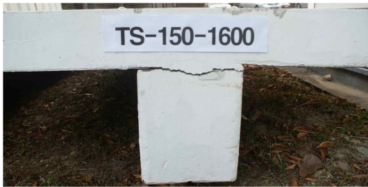
사진 1. 상부 콘크리트와 TSC 보 사이의 균열
