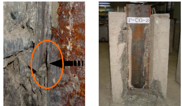
(a) 시어 커넥터 용접부 파괴 (b) 하부 콘크리트 파괴 그림 9. P-CO 시리즈 실험체 파괴양상
